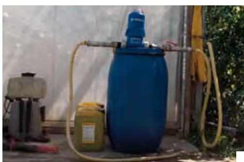
Vinasse wird zum Bewässerungswasser gegeben. Nach einer Düngergabe muss das gesamte Bewässerungssystem mit Wasser gespült werden.
